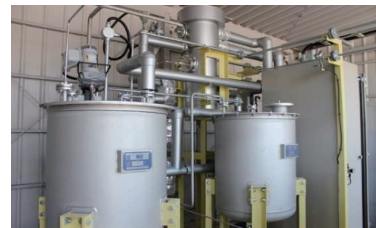
写真5 メタノール回収装置の例
