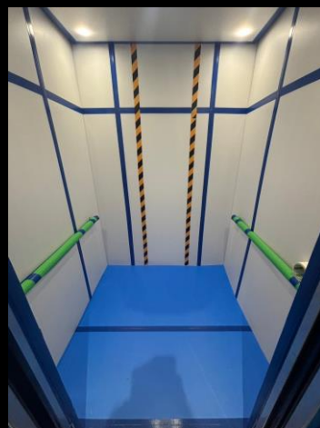
エレベーター内部
