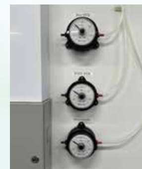
室圧はPCD制御により常時-20Paを維持
