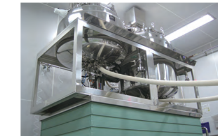
調製装置(溶解槽)
