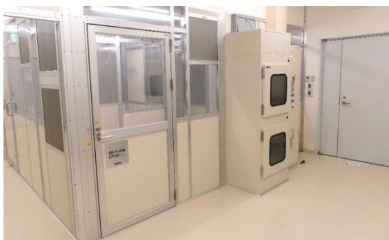
設置したオールインワン CP ユニット
