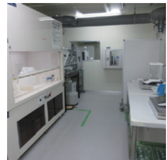
クリーンルーム
